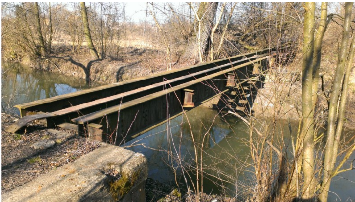
Ilustracja 4: Stan techniczny konstrukcji mostu na rz. Nidzica umożliwia budowę kładki rowerowej.
