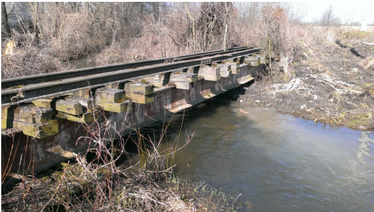
Ilustracja 8: Zachowane elementy mostu w Konieczmostach.
